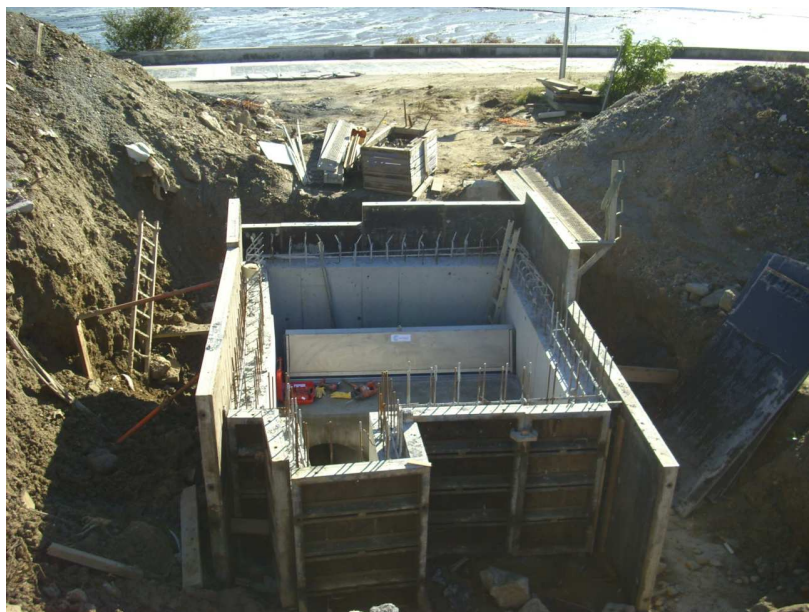
Aliviadero con el flap instalado
